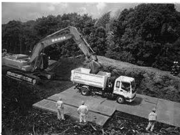
図表 3-2-20 支障除去事業 - (不法堆積された木材チップの除去)
