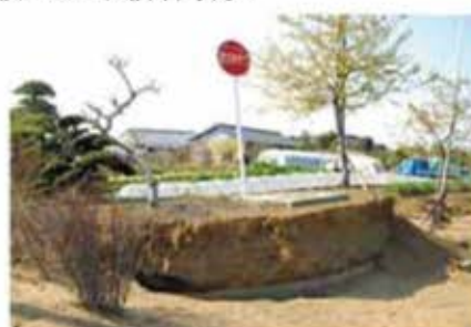
液状化による被害(防火水槽の浮上)
