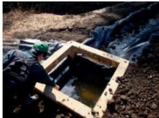
↑残土事業場の立入検査
