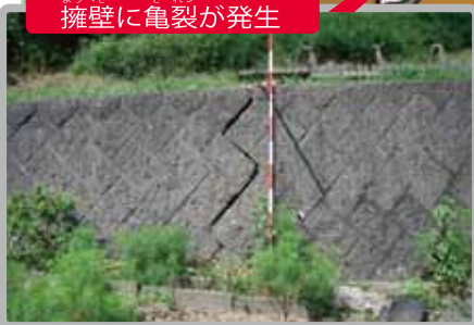
擁壁に亀裂が発生
