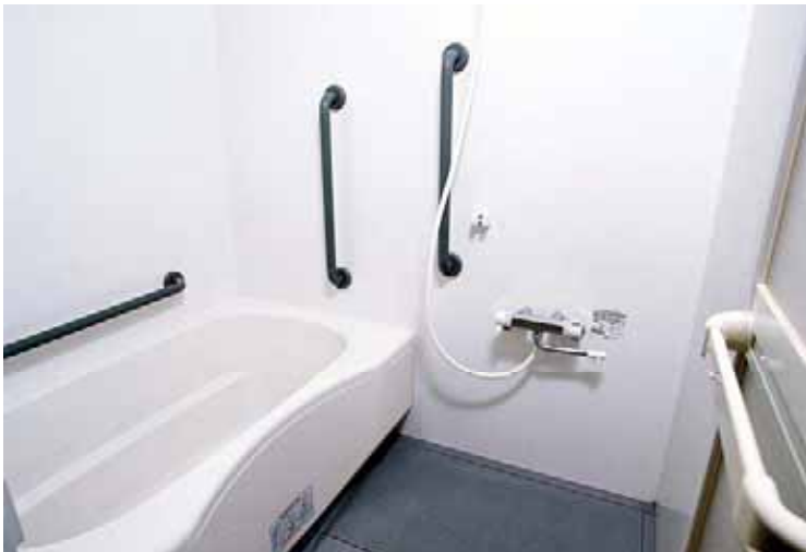
手すりのついたユニットバス
