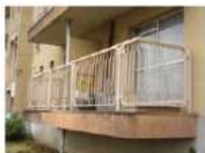
バルコニー手摺の改修前
