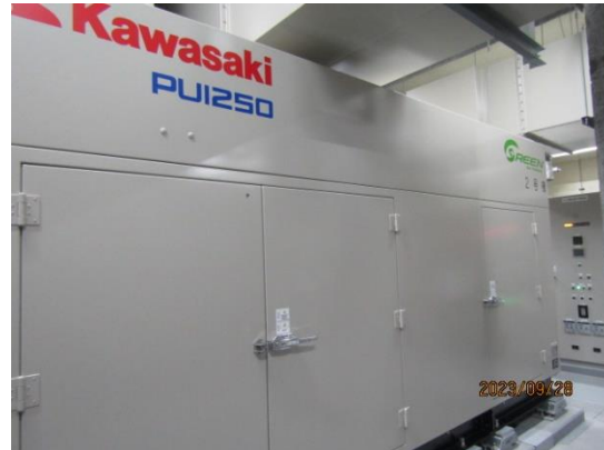
自家発電設備（4階）
