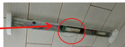
蛍光灯の安定器
