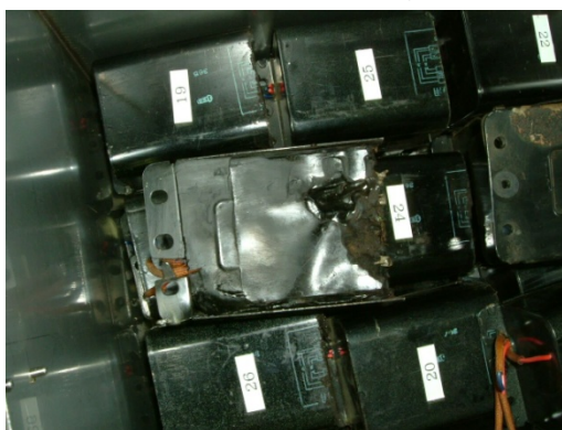
切断された廃安定器の保管例 (2)
