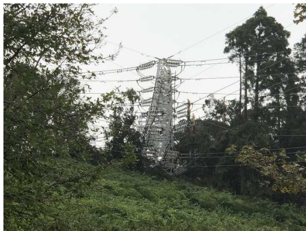
君津市かずさ小糸（鉄塔倒壊）
