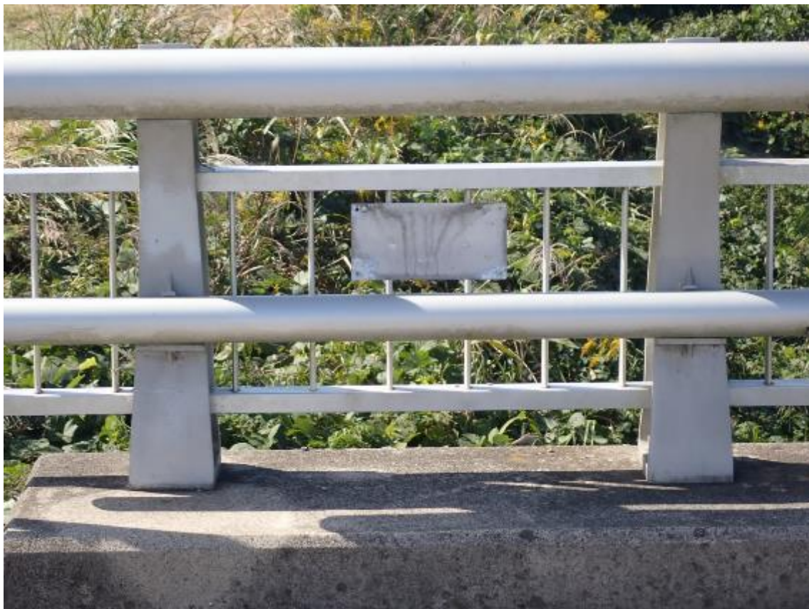
発生場所①（盗難発生後）
