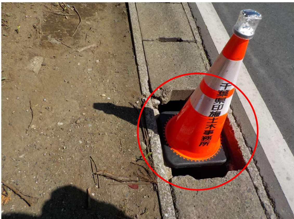
応急処置（セーフティコーン設置後）
