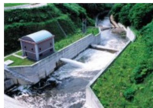
利水放水設備 取水設備からの流量をコントロールする設備
