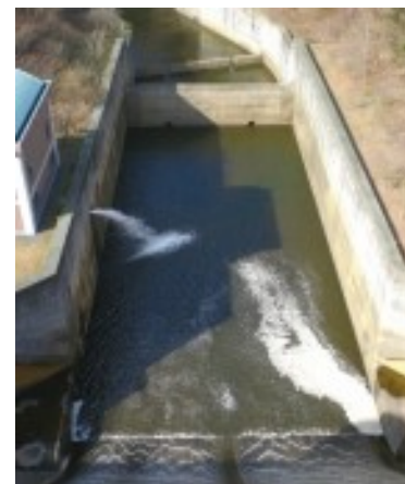
減勢工 洪水吐から流れる水の勢いを弱めるための設備
