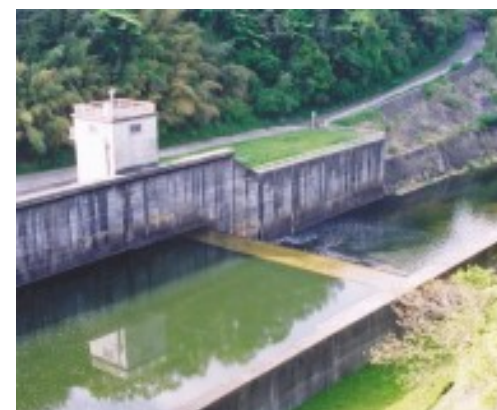
減勢工 洪水吐から流れる水の勢いを弱めるための設備
