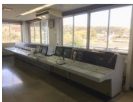
龜山・片倉ダム管理事務所内の操作卓
