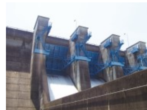
クレストラジアルゲート 洪水時に使用する放流設備
