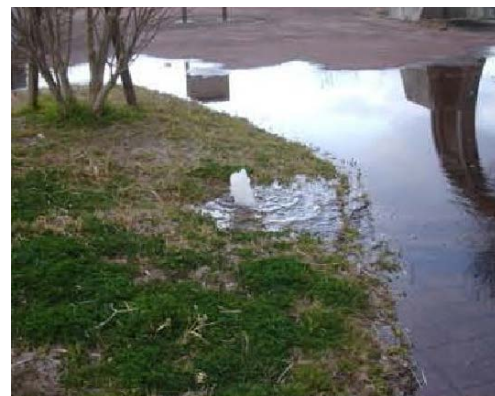
水道管の損傷によりあふれ出た水
