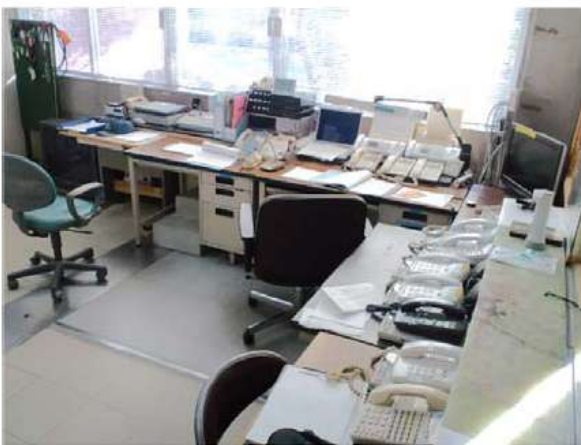
大洗町消防通信指令室（大洗町提供）
