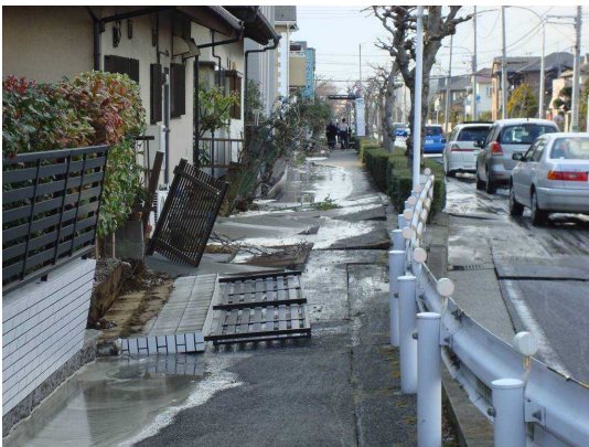
写真 1-3-8 (58 ページ) 道路の隆起、土砂の噴き出しが発生した。 (習志野市香澄：習志野市提供)
