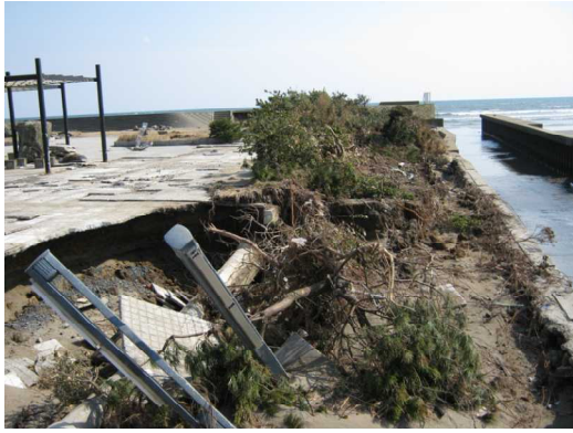
写真 2-2-15(106 ページ) 津波の進入口となった矢指川河口。松や支柱が上流側に倒れている。 (旭市椎名内：防災危機管理部撮影)
