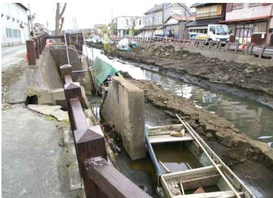
写真 3-4-15(179 ページ) 液状化と側方流動による噴砂と護岸倒壊 (香取市・小野川：県土整備部提供)
