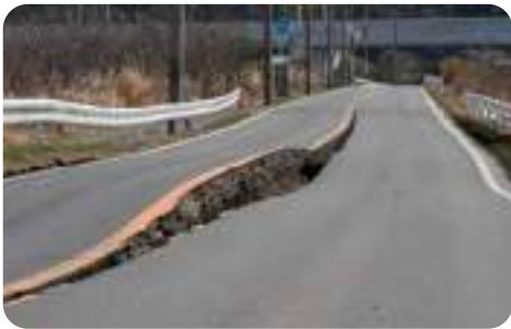
もり上がってひびが入った道路
