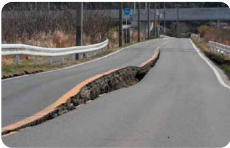
もり上がってひびが入った道路
