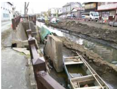
写真 3-4-15 液状化と側方流動による噴砂と護岸倒壊 小野川（香取市）
