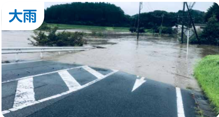
道路にあふれた雨水
