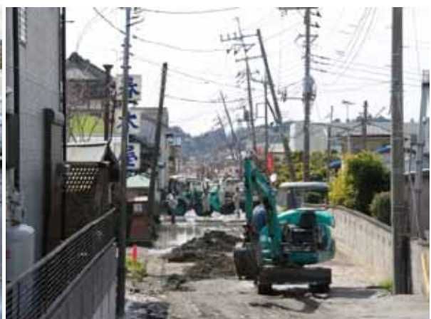
写真 1-3-9 噴出した砂の撤去 (香取市水郷町・粉名口：香取市提供)
