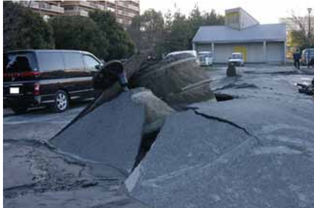
写真 1-3-1 マンホールの浮き上がり (浦安市高洲：浦安市提供)
