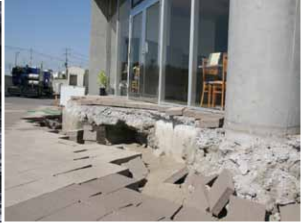
写真 1-3-5 液状化による抜け上がり (アクアリンクちば：千葉市提供)
