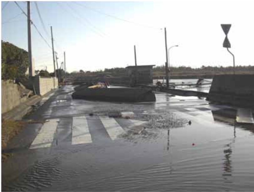
写真 1-2-5 津波により損壊した 防潮壁（写真中央） （匝瑳市横芝光町 消防組合消防本部提供）
