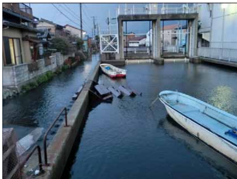
写真 1-2-7 海水が側溝から溢れ 道路が冠水 （市役所周辺：木更津市提供）
