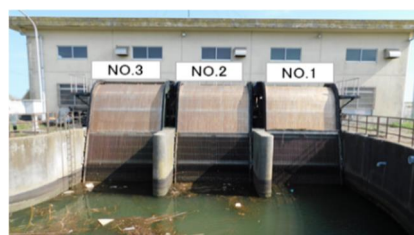
除塵機設備(全景)
