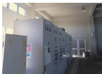
細草揚水機場電気設備
