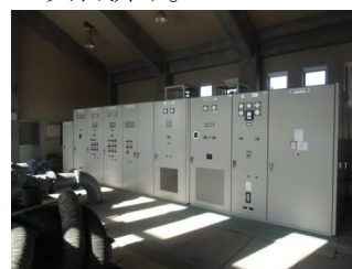
四天木揚水機場電気設備
