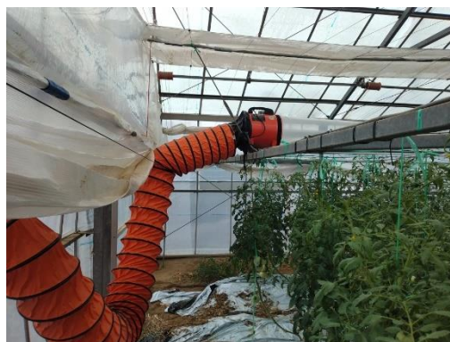
高温対策の外気導入
