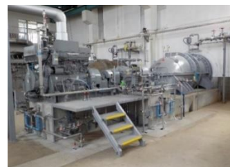
湛水被害を防ぐ排水ポンプ
