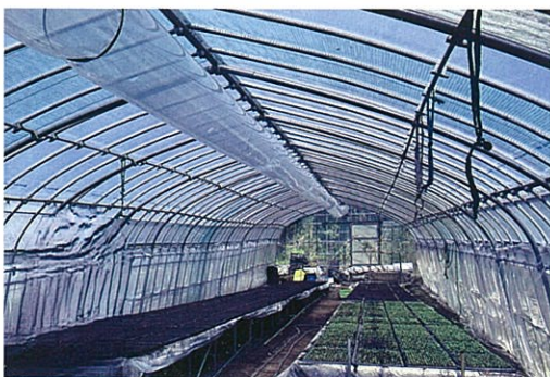
外気導入ダクトの設置例
